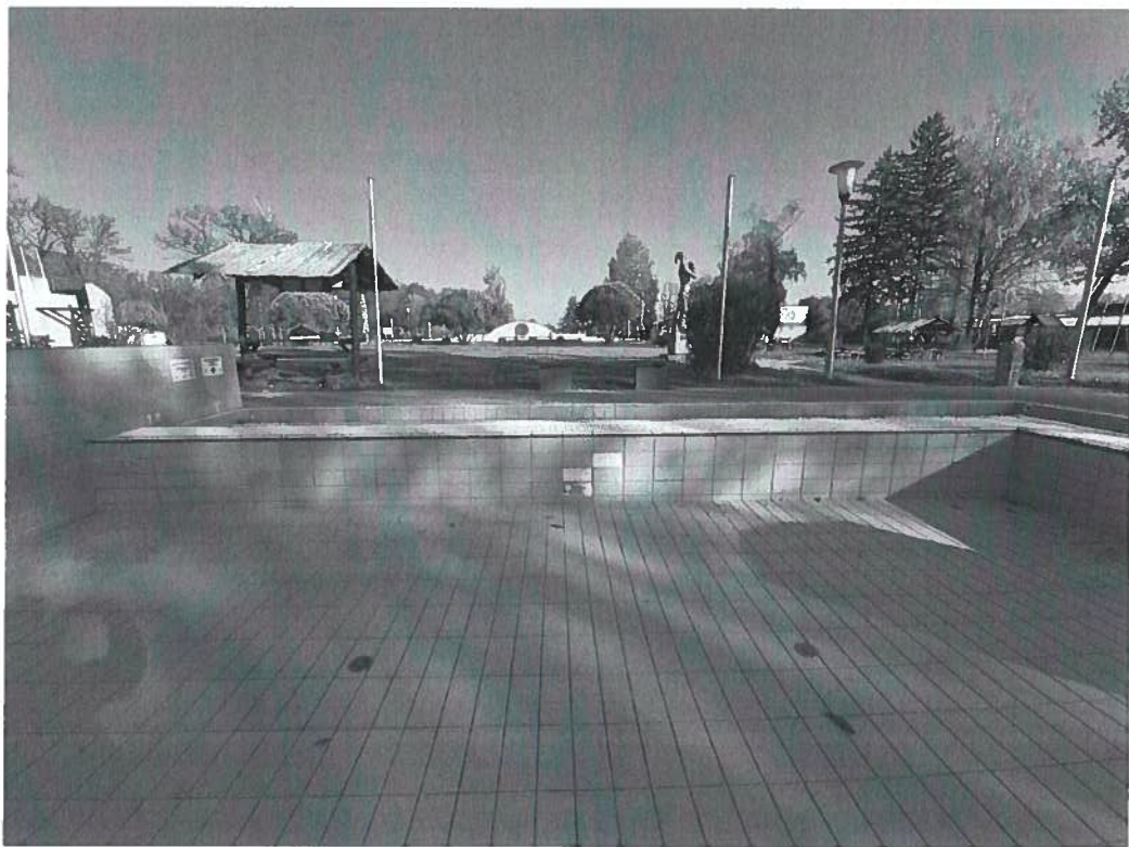
8. kép - gyerekmedence keleti fala, repedések nem láthatók
